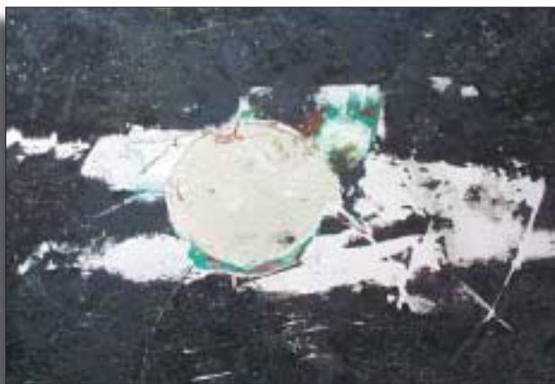
Cloquage superficiel sans conséquence à ce stade, sur l'intégrité structurelle du bordé.
