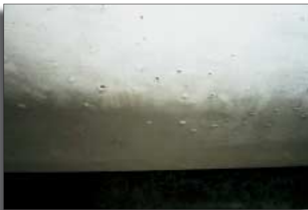
Cloquage osmotique le plus souvent rencontré sur les coques anciennes.
