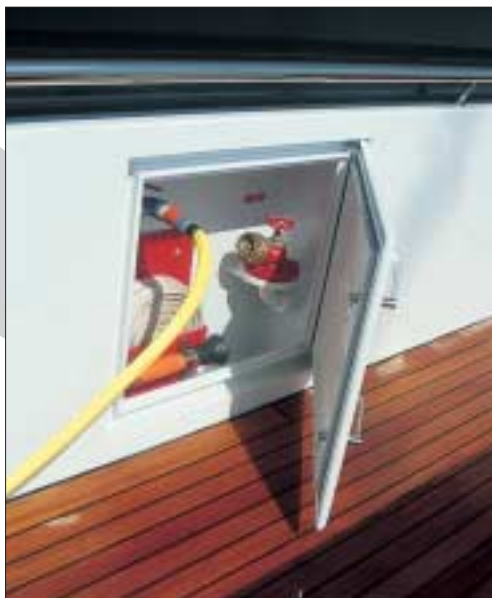
Renforcement des systèmes de lutte contre les incendies.
