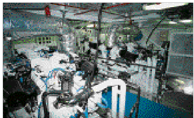
A cause du peu d'espace, le démontage d'un arbre ou d'un inverseur doit être prévu dès la conception.
